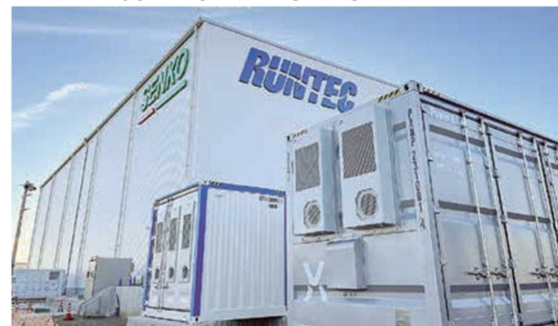
大容量蓄電池の設置
