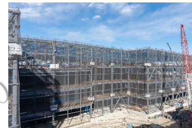
データセンター
