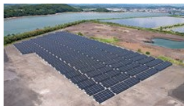
山口事業所の 太陽光発電設備
