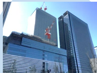
マンション・オフィスビルなど
