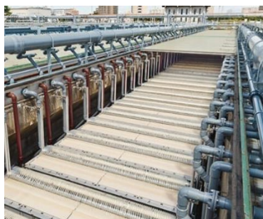
水処理プラント
