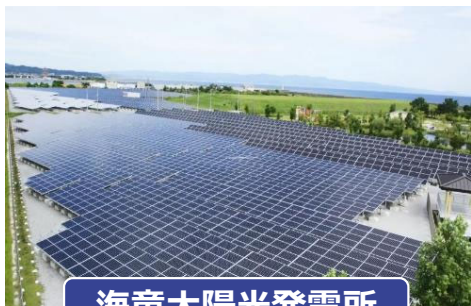
海竜太陽光発電所
