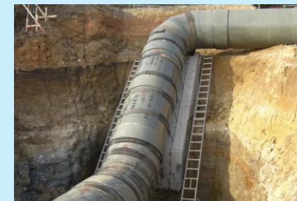
小水力向けパイプライン (FRPM管)
