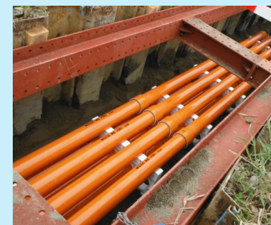
電力ケーブル 保護管
