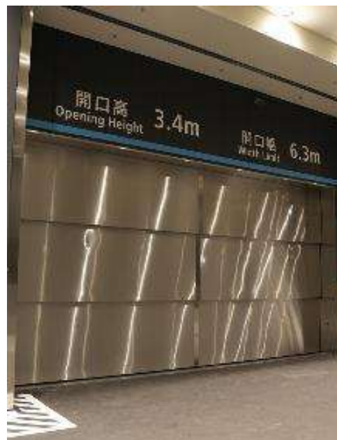
荷物用エレベーター
