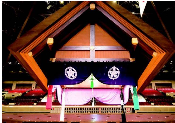
国技館（大相撲屋形升降装置）
