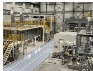
三島工場で稼働した CNF 複合樹脂「ELLEX-R67」 商用プラント
