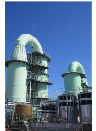
ヨウ素製造設備
