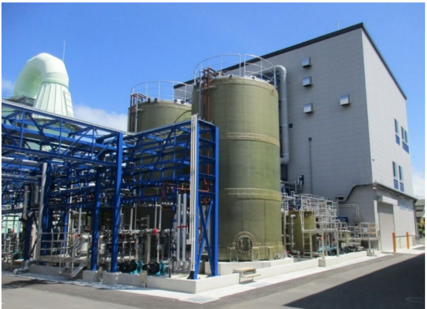
ヨウ素精製工程(後半工程)設備
