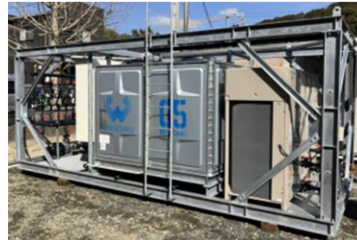
AI水温制御パイプクーリングシステム
