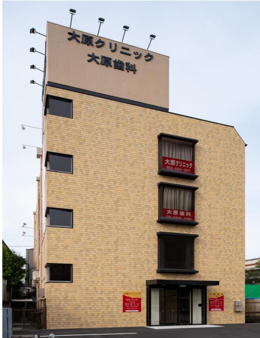
RC造・吹付塗装仕上げの既存壁にサイディングを重ね張り
