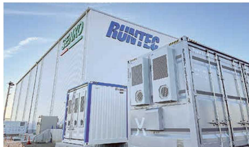
大容量蓄電池の設置
