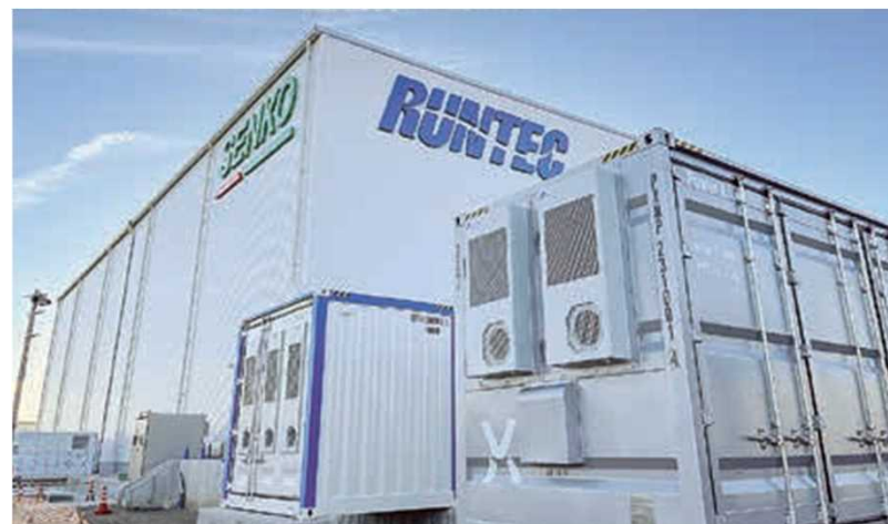
大容量蓄電池の設置
