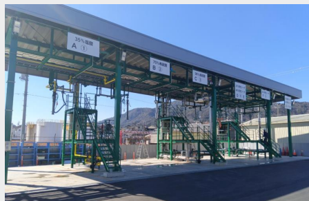
タンクローリー用出荷設備
