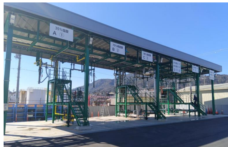
タンクローリー用出荷設備 全景
