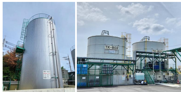
力性ソーダタンク、塩酸タンク
