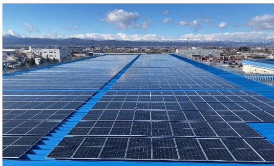
山形工場の太陽光パネル
