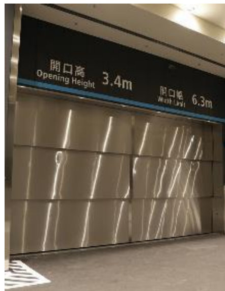
荷物用エレベーター
