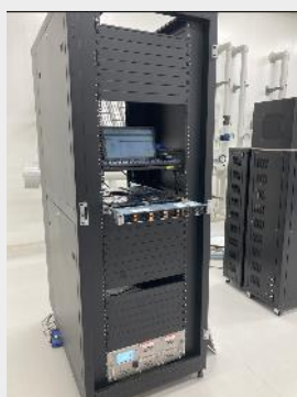
水冷サーバー
