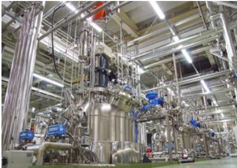
構造タンパク質 発酵設備
