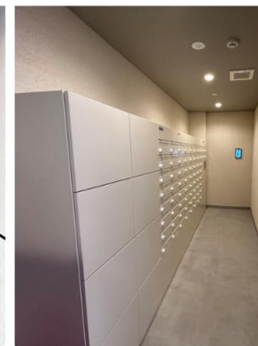
▲ 宅配ボックス
