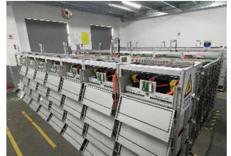
中古電池を使用した ESS実証機
