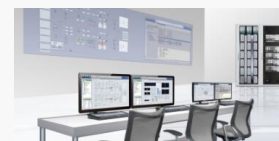
総合生産設備
