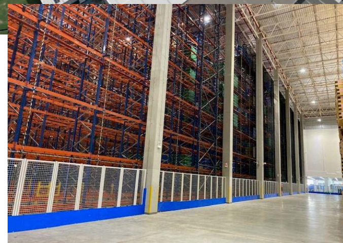
倉庫内に自動倉庫を設備
