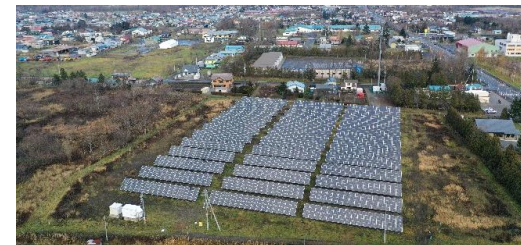
芦別太陽光発電所
