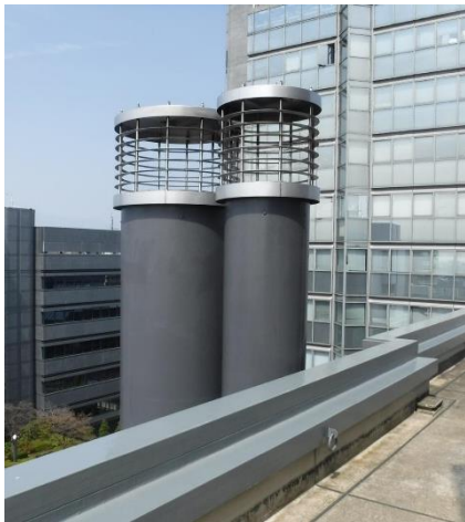
ビル用煙突 (オーダーメイド)
