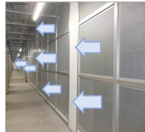
壁面全面から空調空気をサーバーへ供給
