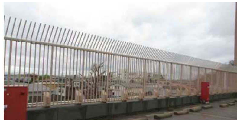
屋上転落防止ネット
