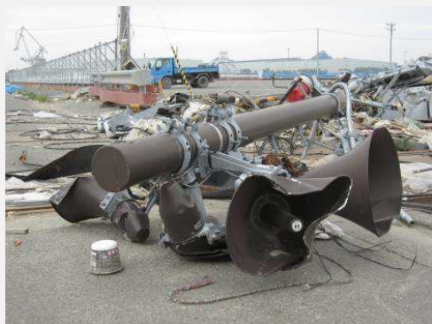
東日本大震災の津波で倒壊した 防災無線屋外子局
