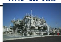
オープンラック式LNG気化器
