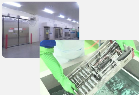
冷蔵設備・洗浄設備
