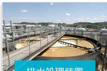
排水処理装置
