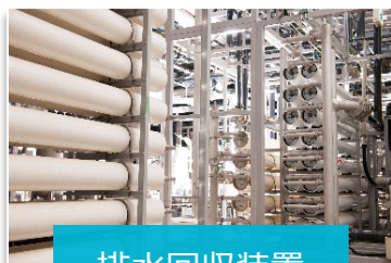
排水回収装置
