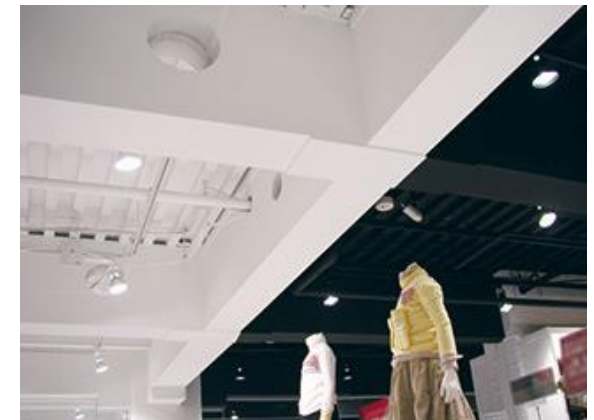
はりの耐火被覆（商業施設）
