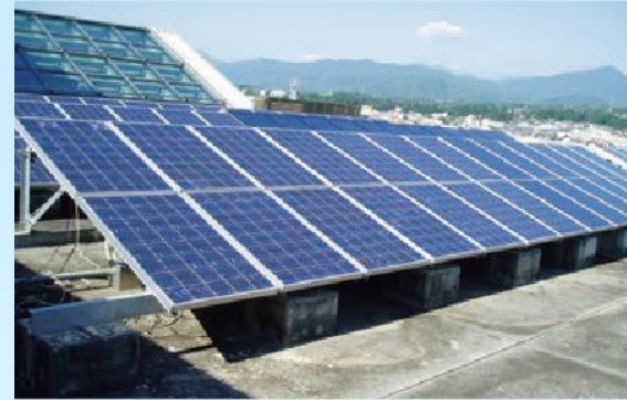
太陽光発電設備
