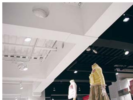
はりの耐火被覆（商業施設）
