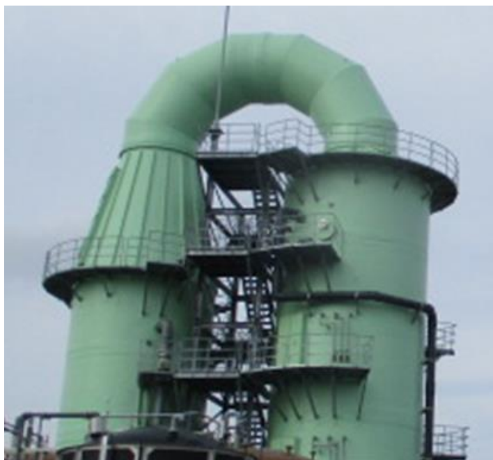
稼働中のBO法生産設備 ※日天千葉工場No.2（2017年稼働）
