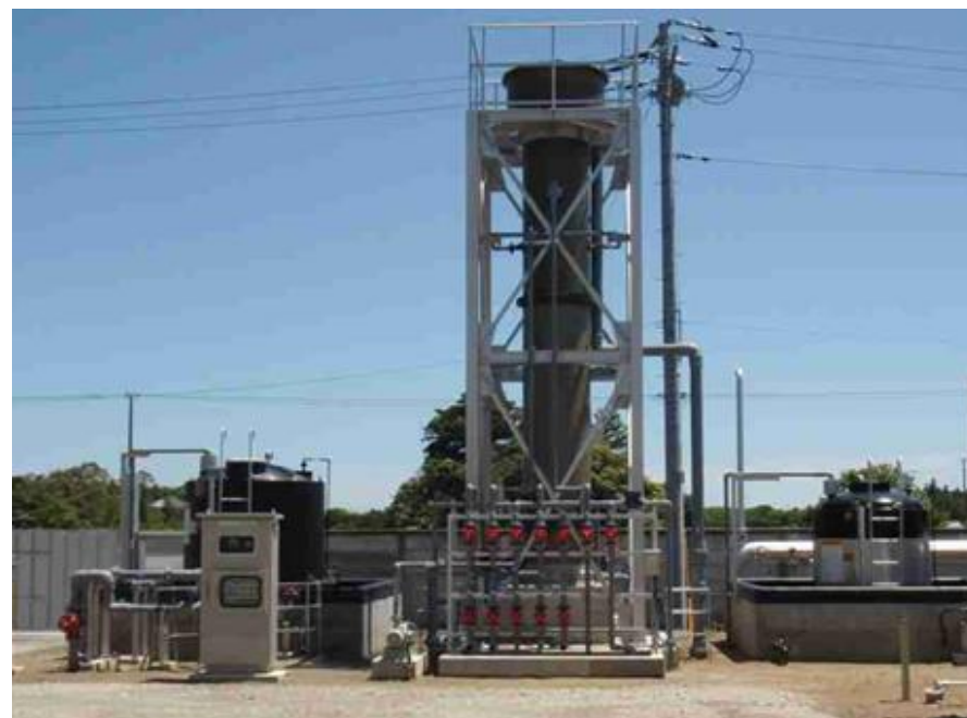
稼働中の井戸元吸着設備 ※NWH-1（2014年稼働）
