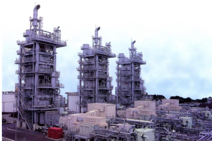
五井コストエナジー(株) 五井発電所
