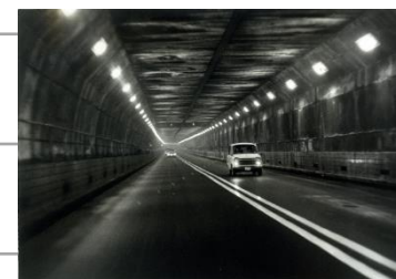
関門海底トンネル照明器具
