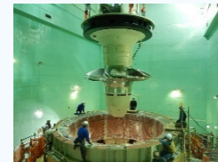
秋葉第一発電所のリパワリング
