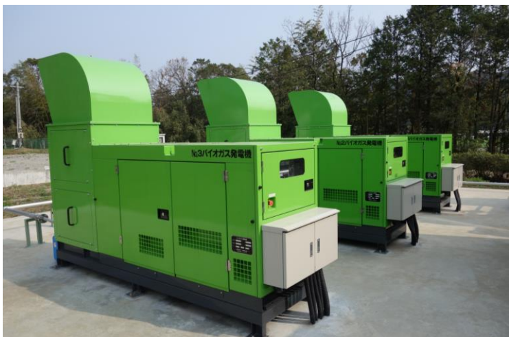
バイオ発電機
