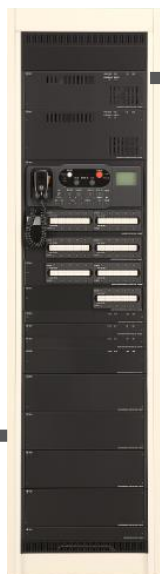
既存の非常用放送設備
