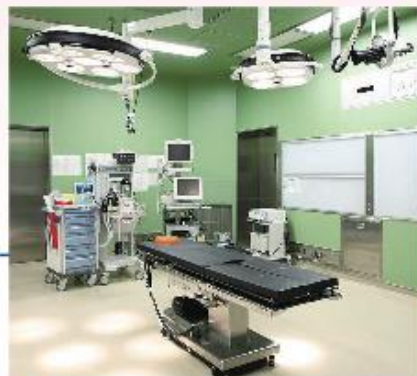
■ 病院 (クリーンルーム)
