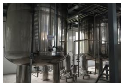
中国: 無錫澄泓微電子の設備
